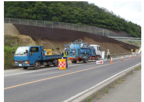
【参考】種吹付設備
