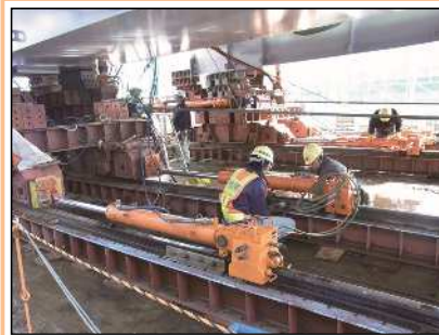
送出し装置用遮断防止装置
